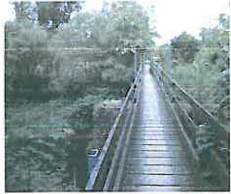
La passerelle aménagée sur l'ancien ouvrage militaire doit être entièrement reprise
