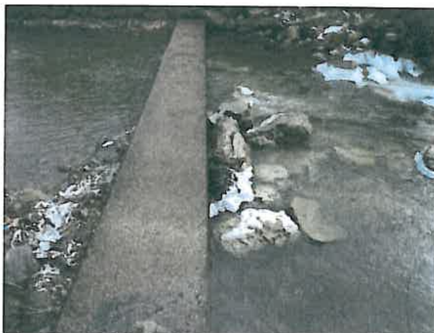
Seuil Station d'Épuration après la brèche
