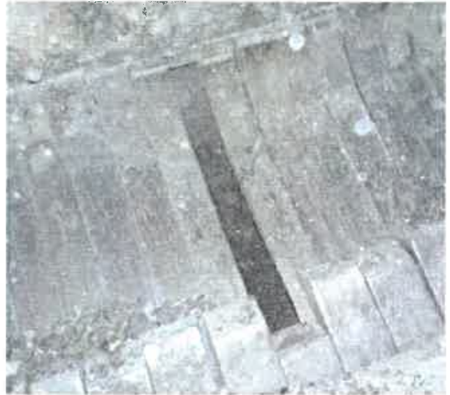
Casse de barreaux sur la grille
